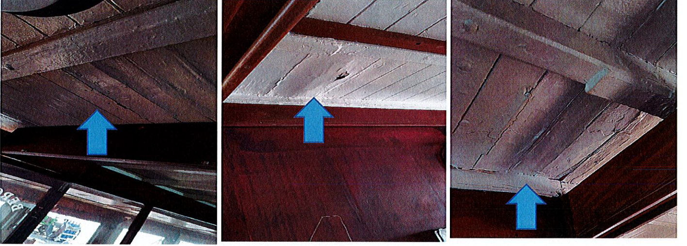
Geminin çatı kısmının altındaki çürük ahşapları gösterir resim
